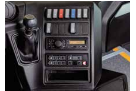
Yeni Klima ve Kalorifer Kumanda Kontrol Paneli
